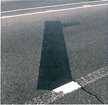
一般国道リフレクションクラック補修 目的：ひび割れ抑制、段差解消 交通量：約 10,000 台 / 日 (カーブ内) 撮影日：施工後 2 年 6 か月経過時
