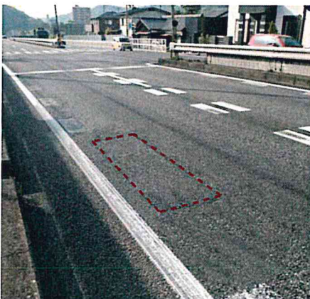
国道交差点付近の高機能舗装補修 目的：耐流動、破損対策 交通量：約 15,000 / 日（交差点付近） 撮影日：施工後 2 年 5 か月経過時
